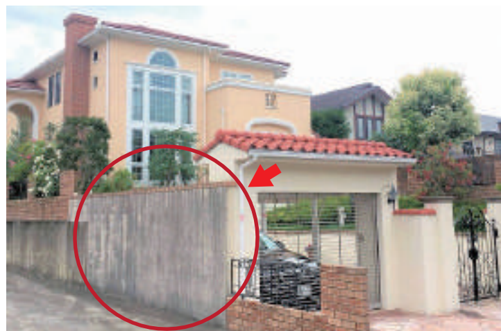
＜施工前＞天端の目地が太くて深いため、それぞれの目地から汚れが垂れていた。
